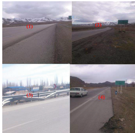
شکل ۲- برخی مشکلات ایمنی مسیر بعلت عدم به کارگیری صحیح تجهیزات ترافیکی
